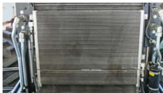
Великі блоки системи охолодження очищуються без зусиль.
